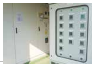
MDB ルーム に設置された エコパワー メータ
